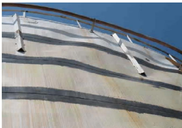
Рисунок 1 – Потеря устойчивости верхних поясов стенок резервуара [1]
